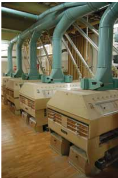
Putsmaskinerna i durumkvarnen.
